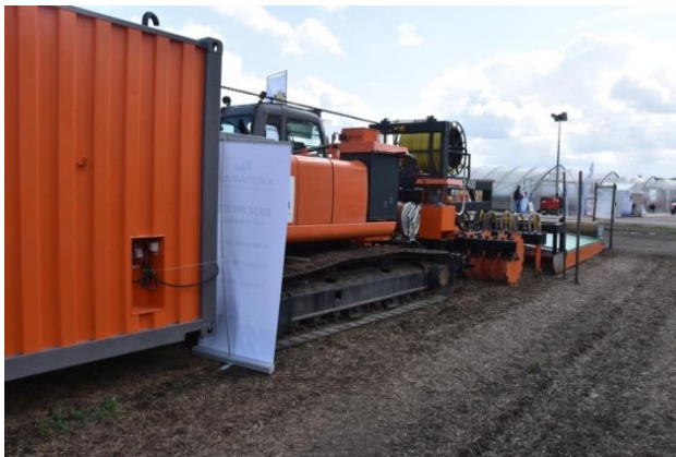
Bild 10: Besuch der Fachmesse INTERASPA am 07.09.2017 in Visbek, Besichtigung Dämpfraupe mit Injektionsdämpfverfahren von Fa. www.soilsteam.com
